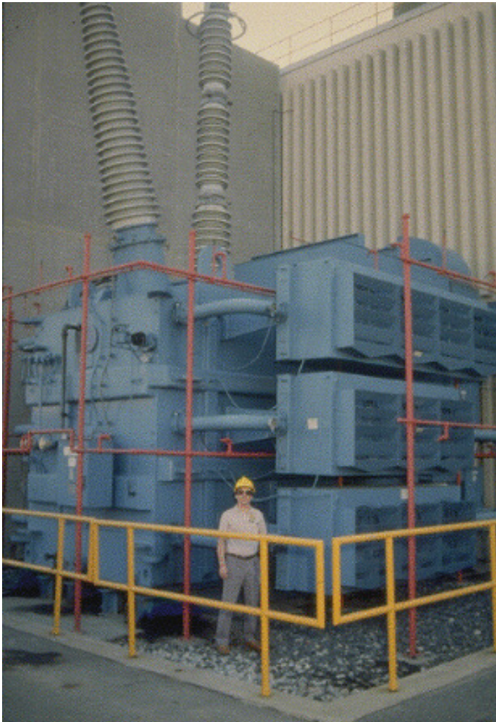
Βλάβη μετασχηματιστή στο πυρηνικό εργοστάσιο του Salem, κοντά στη Βοστώνη, το Μάρτιο του 1989
